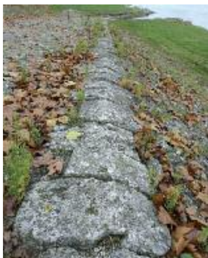
Fig. 39 : Envahissement progressif par une végétation herbacée.
