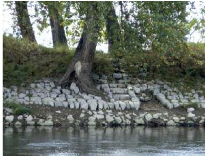
Fig. 200 : Dégradation d'un duit par développement d'une végétation non maîtrisée.
