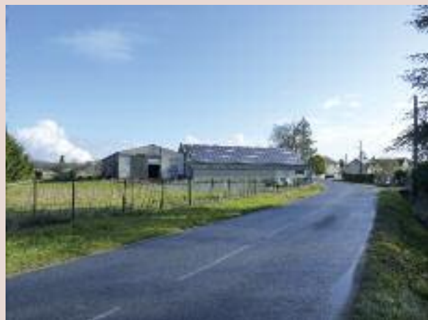
Fig. 156 : Panneaux solaires couvrant la totalité du versant de la toiture d'un hangar agricole.
