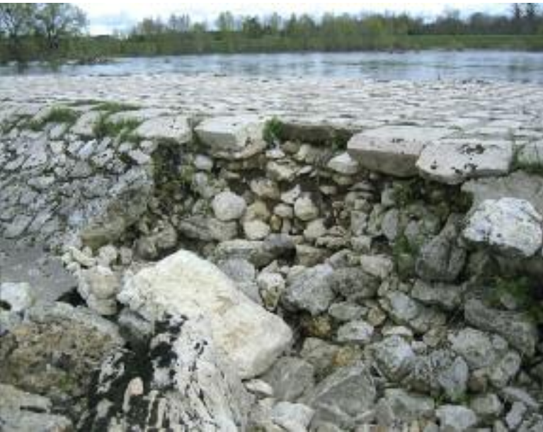
Fig. 199 : Affouillement en pied de duit.
