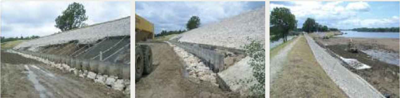
Fig. 202 : Travaux de confortement de la digue à Combleux, Loiret : Mise en place d'enrochements dissimulant les palplanches et reconstruction du perré dégradé.
