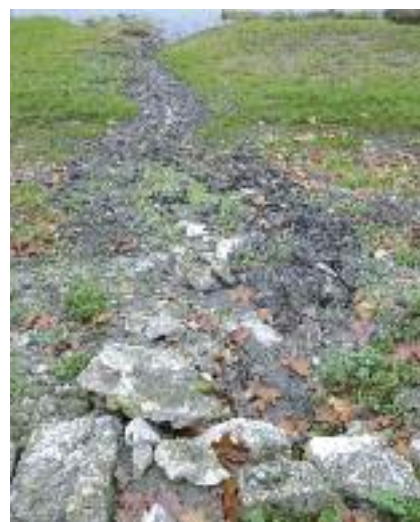
Fig. 41 : Rejet de canalisation érodant et dégradant le pavage.
