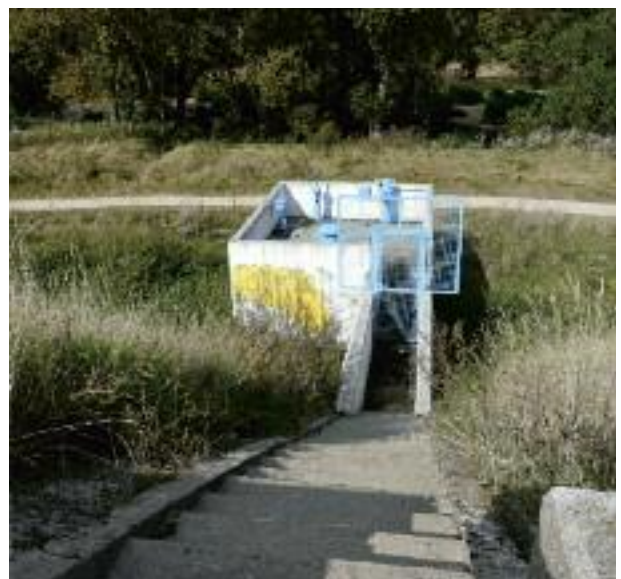
Fig. 201 : Local technique en pied de digue. L'escalier est entièrement refait en béton.
