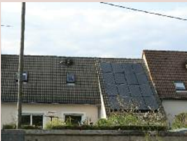
Fig. 155 : Panneaux solaires couvrant la quasi-totalité d'un pan de toiture d'un garage.
