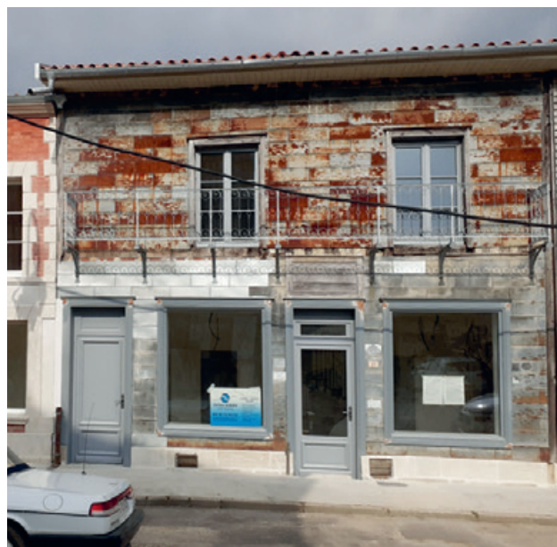
Façade en piteux état avant réfection du bardage de tôles © Mairie de Chavanges
